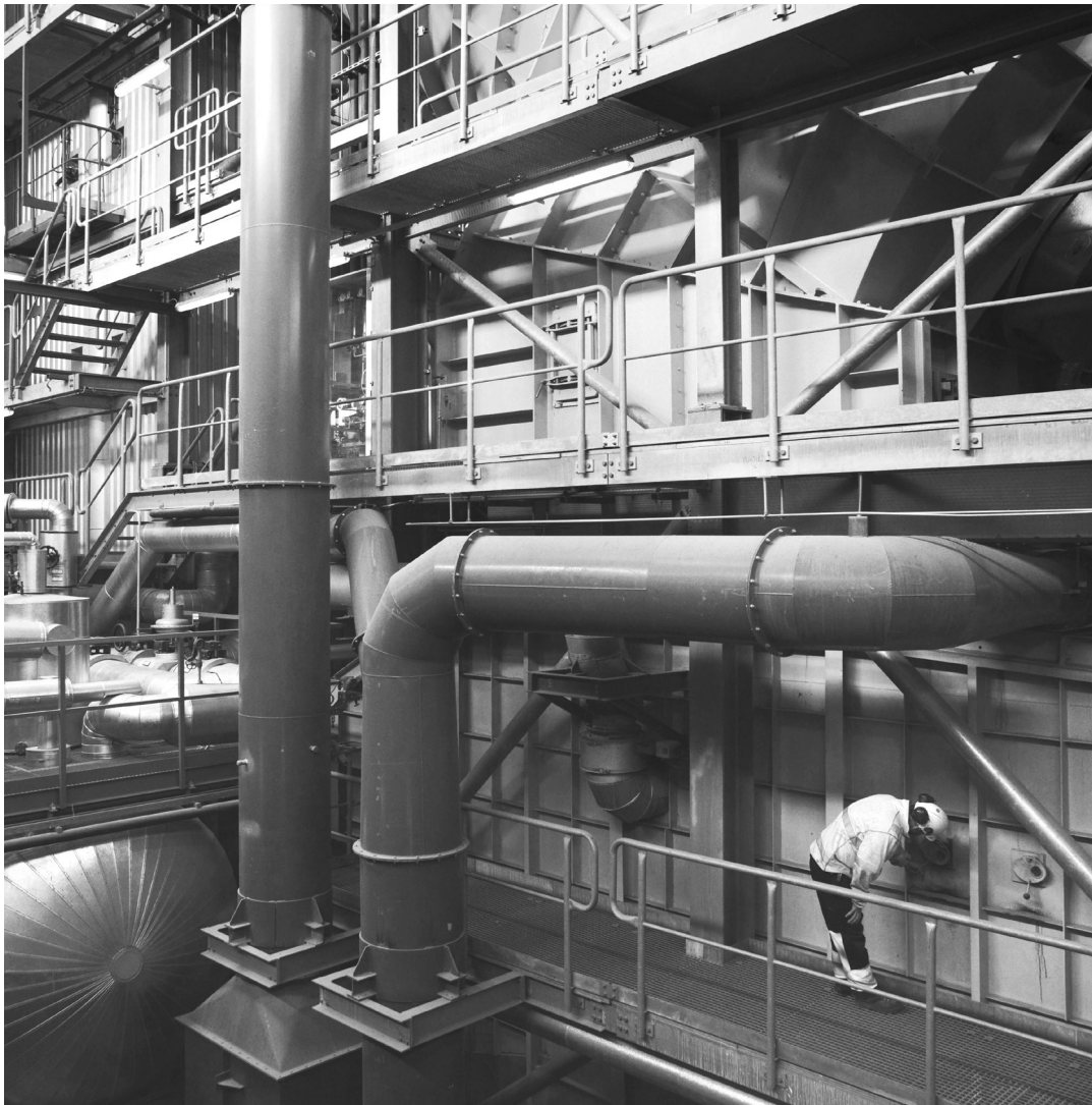
Axpo Tegra AG, Holzkraftwerk in Domat/Ems (Bild: Jesco Tscholitsch)
