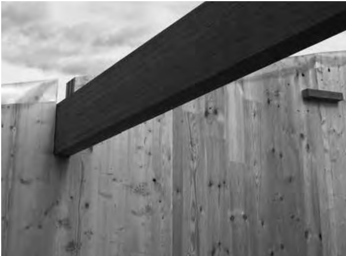
Buchenunterzug im Obergeschoss eines mehrgeschossigen Mehrfamilienhauses (Bild: holztragwerke.ch AG)
