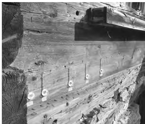
Praxisuntersuchungen zur Feuchteaufnahme an historischen Blockbauten im Oberwallis. (Bild: BFH)
